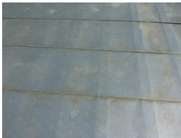
Rys. 4.10. Zaginanie blachy pokrycia wzdłuż krawędzi łączników w systemie Tytanium Pruszyński [11]
